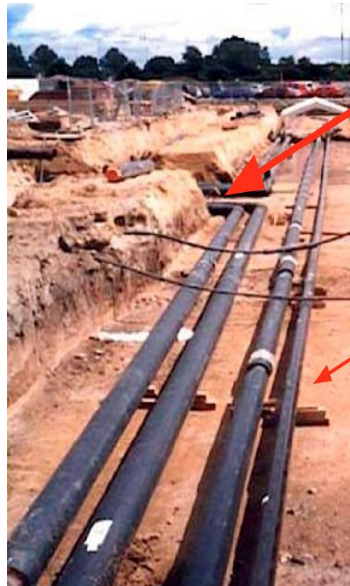
Металлические трубы с компенсатором
